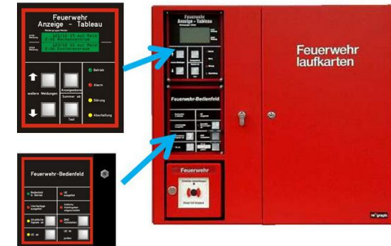
Bauteile einer Brandmeldeanlage (BMA) Feuerwehrinformationszentrale (FIZ)
