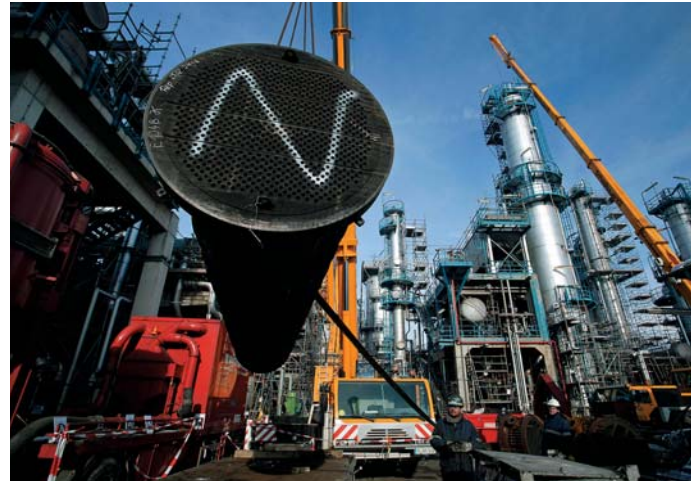
Gerüste und Arbeitsflächen mußten täglich kontrolliert und notfalls mit eisernem Besen gereinigt werden.
